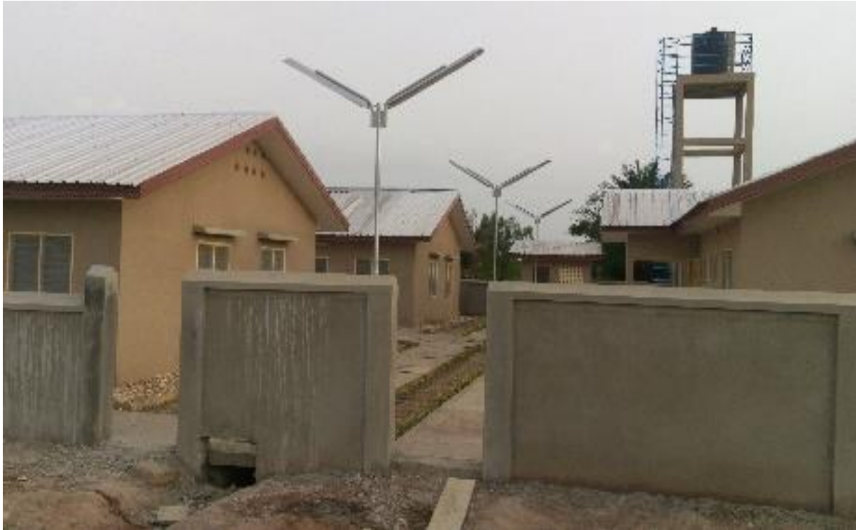
De tre husen i Awoyo är nästan färdigställda, i alla fall på utsidan. Foto: SOS Arkiv
